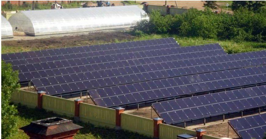
Электростанция для энергоснабжения тепличного комплекса на о-ве Валаам
