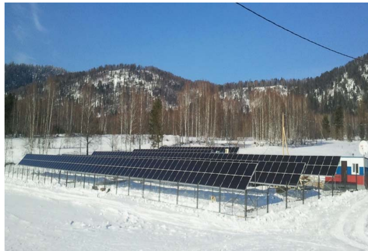
Автономная дизель-солнечная электростанция Республика Алтай
