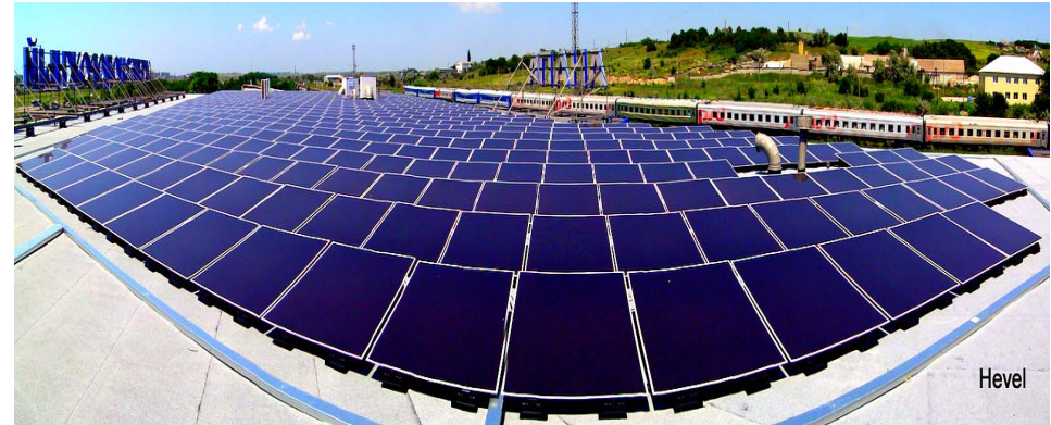
Крышная установка на ж/д вокзале города Анапа
